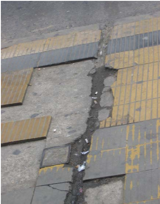
Baldosa quebrada y desprendida
