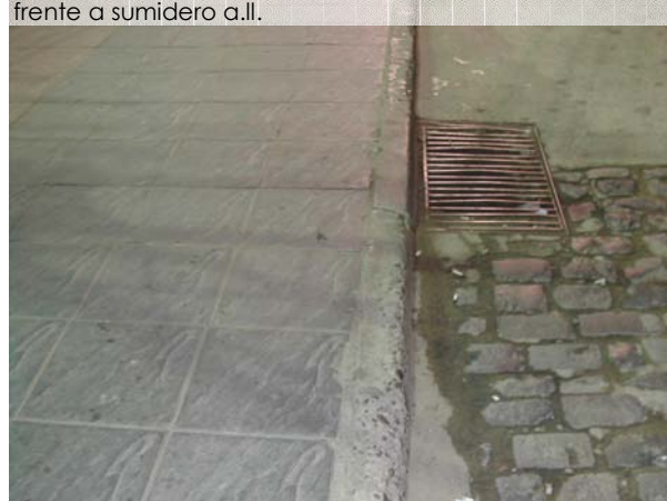
Solera de Hormigón en mal estado, solera de Piedra frente a sumidero a.II.
