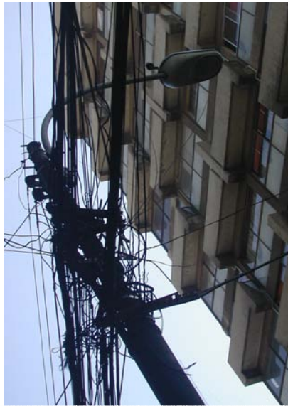
Poste Luminaria y contaminación visual de tendidos adosados
