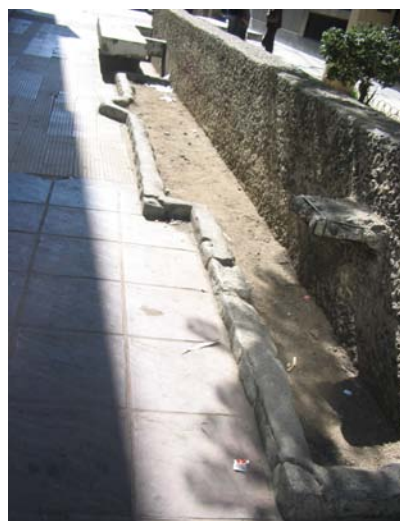
Muros en mal estado
